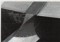
Le carénage de dessous d'aile est plaqué contre le fuselage avec des vulgaires clous.
